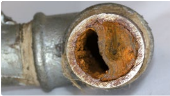
Tubería con depósitos calcáreos
