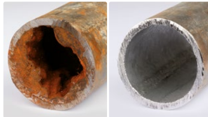
Sistema de tuberías
