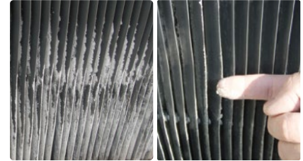
Rejilla de torre de refrigeración
