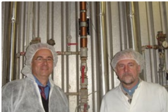
Vulcan instalado en una fábrica de alimentos
