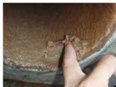
Los depósitos calcáreos en la tubería de circulación también pueden retirarse pasando un dedo.
