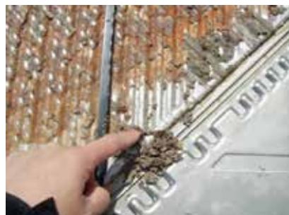
Se ablandan los depósitos calcáreos en el intercambiador de calor de placas.
