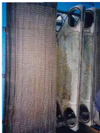
El control de panel de miel llena de torre de refrigeración
