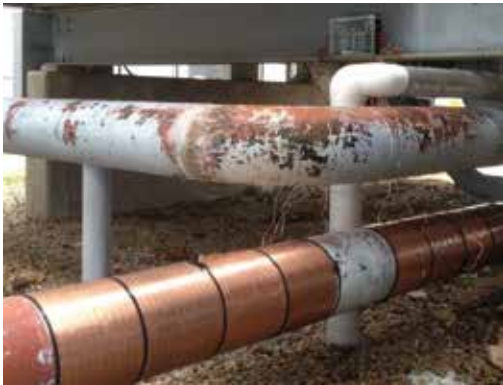
Vulcan S250 instalado en una línea de 10 pulgadas de diámetro que alimenta las torres de enfriamiento gemelas (TC-1 y TC-2))
