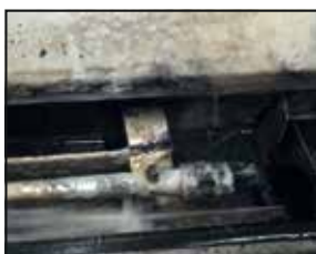
7 de febrero: Observación visual de la máquina 1 antes de instalar el Vulcan. La pared y las boquillas tienen incrustaciones y bacterias.
