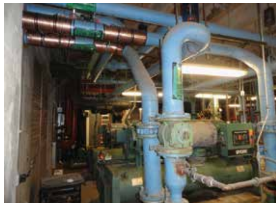
Unidades Vulcan S100 instalados en el doble chiller
