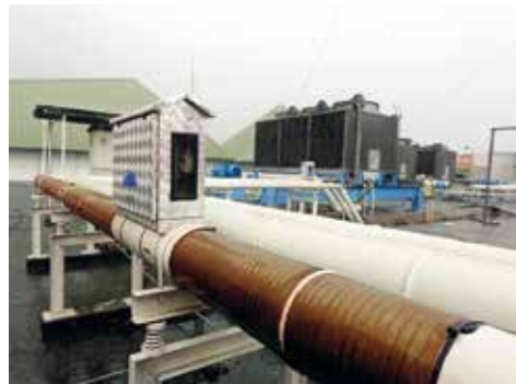
El Vulcan S500 se ubicó dentro de una caja de aluminio y se instaló en la tubería principal de una torre de refrigeración en el centro comercial Karawaci.
