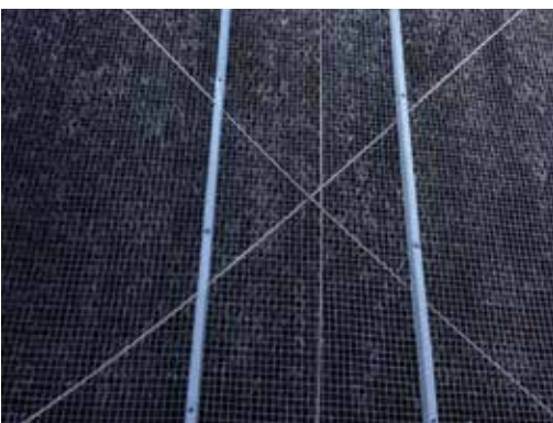
Estas fotos de la CT-1 fueron tomadas después de, aproximadamente, 6 semanas
