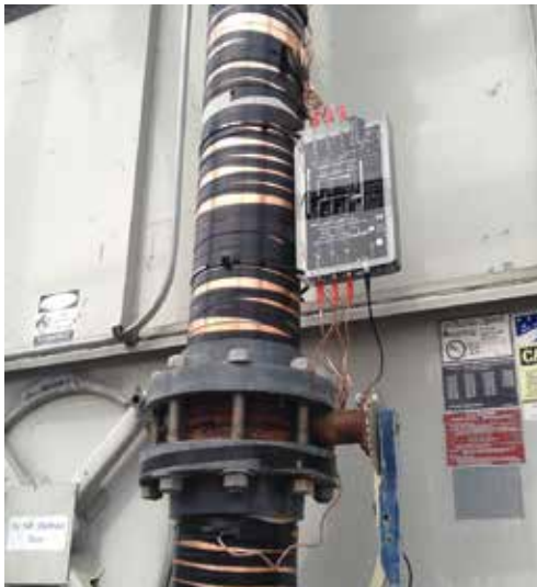
Vulcan S100 instalado en torres de refrigeración
