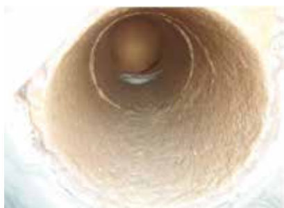
Tubería de circulación
