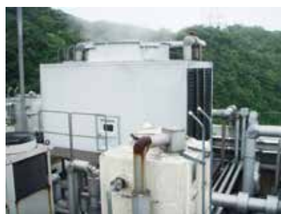
Torre de refrigeración en el techo de la planta
