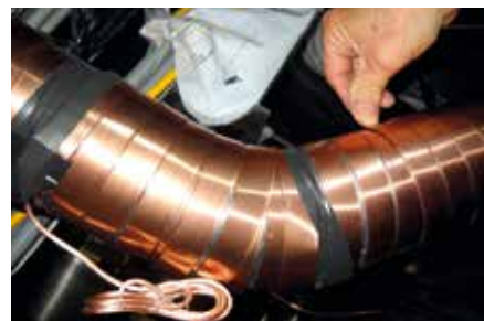
Cables Vulcan de impulso dobles envueltos en la tubería de agua
