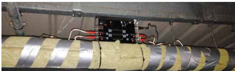
Unidad Vulcan S25 instalada con aislamiento re-envolviendo las tuberías y los cables de impulso
