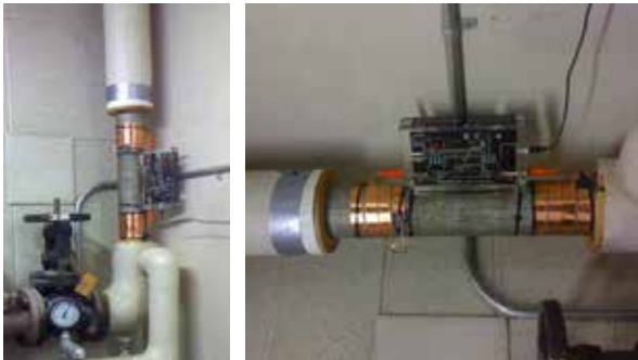
Instalación de Vulcan Desincrustante para todo el suministro de agua en los edificios de la escuela Roosevelt
