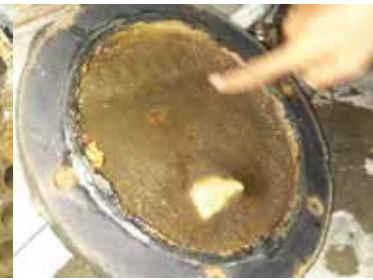
Interior del intercambiador de calor. El recubrimiento del condensador ha perdido toda la escala que tenía antes. (El punto de luz en la parte inferior es reflejo de la luz)
