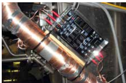
Unidades Vulcan S100 instaladas en el sistema de limpieza
