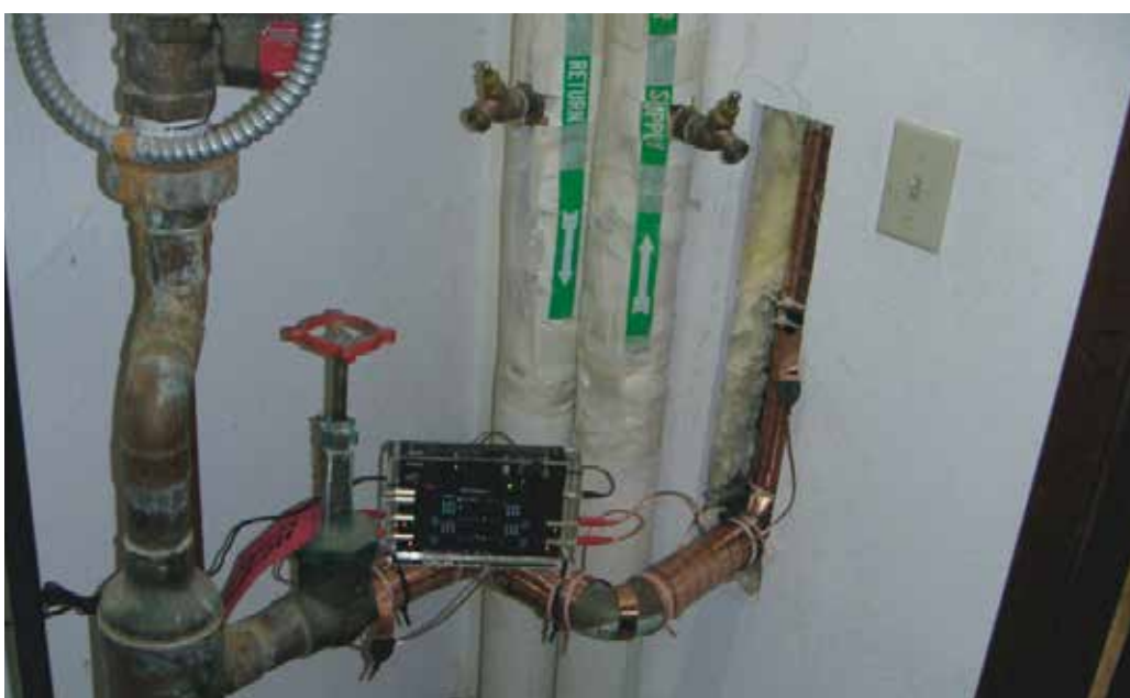
Vulcan S25 instalado en el edificio E en el Centro de Salud
