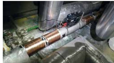
Vulcan S25 instalado en Toray Industries
