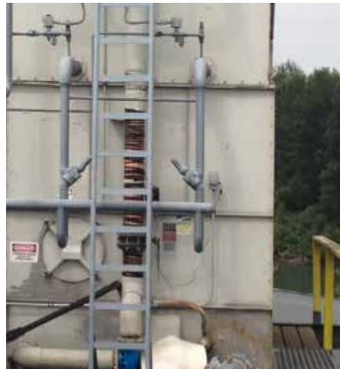
Vulcan S100 instalado fuera
