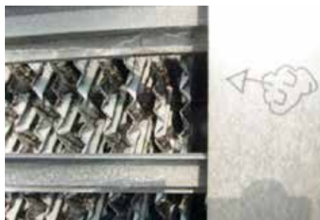
Antes de instalar Vulcan: exterior de la torre de refrigeración.
